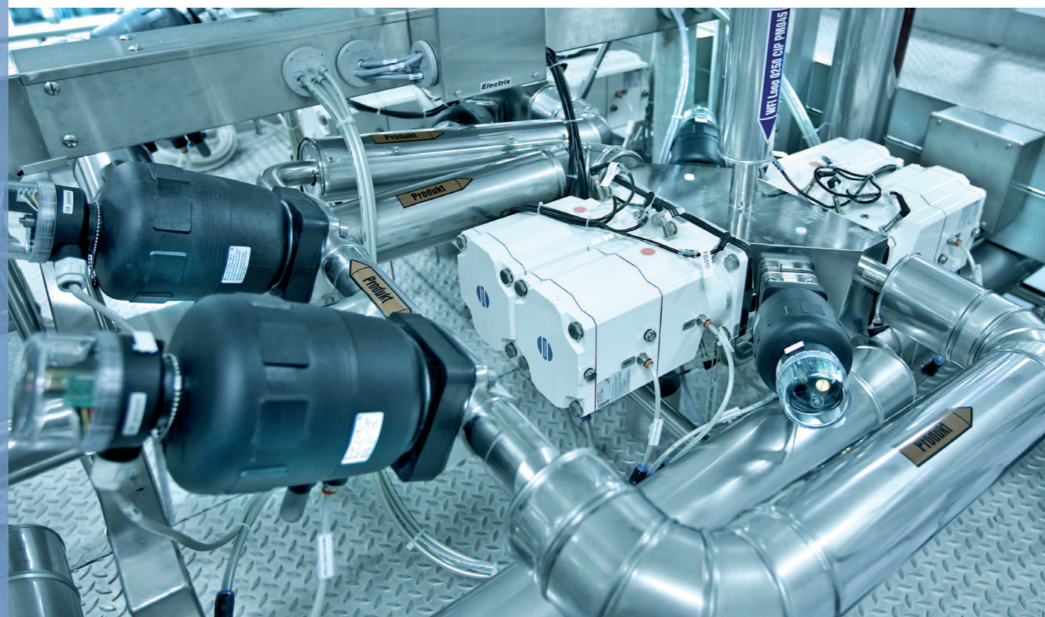
Une conception fluïdique compacte et optimale : un des blocs fonction Robolux, composé de 10 vannes installé dans l'entreprise de B BRAUN.
