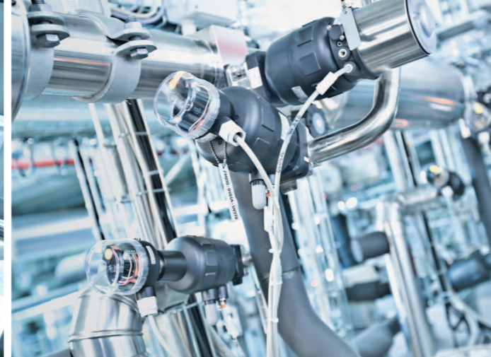
Configuration de vannes dans l'usine B BRAUN.
